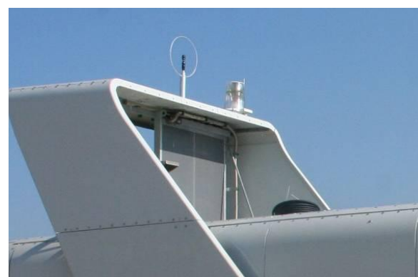
Balisage « feu à éclats » des éoliennes
