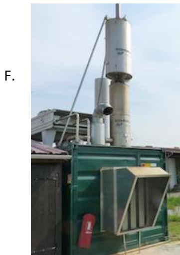
L'échappement du cogénérateur Schnell avec récupération de chaleur, photo Bornschein
