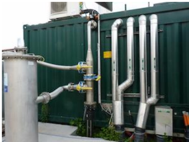
Arrivée de biogaz et départ réseau de chaleur du module de cogénération, photo François Bornschein
