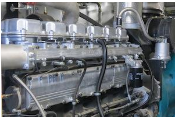
Le moteur de cogénération Schnell est placé dans un conteneur insonorisé
