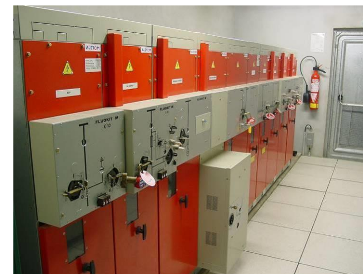
Illustration 12 : Intérieur d'un poste de livraison
