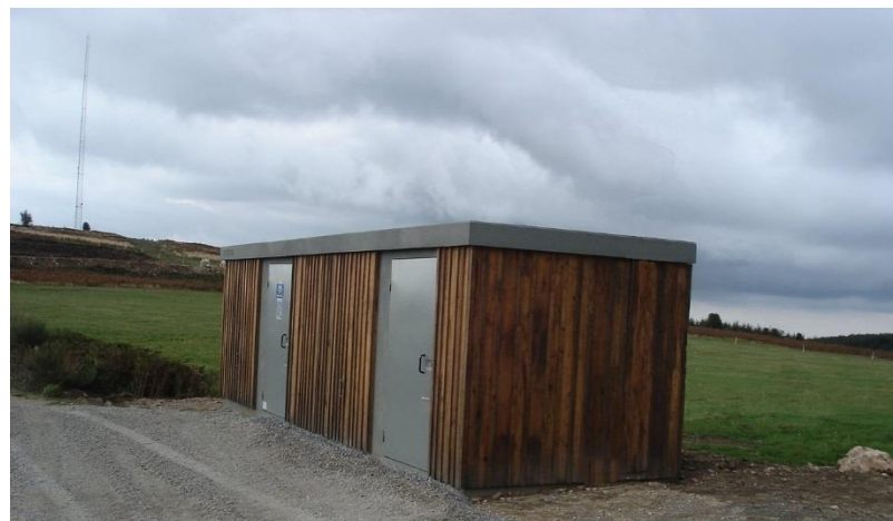
Illustration 14 : Poste de livraison du parc éolien du MARGNES (81)
