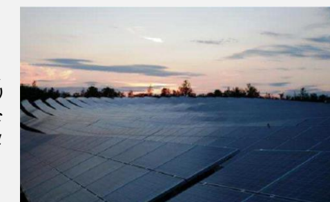
Centrale Solaire du SYCALA Département : Lot (46) Puissance électrique : 8 000kWc Mise en service : Juin 2011
