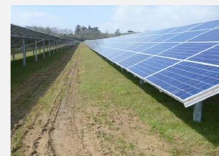
Centrale Solaire de CONDOM Département : Gers (32) Puissance électrique : 10 000 kWc Mise en service : Mars 2013
