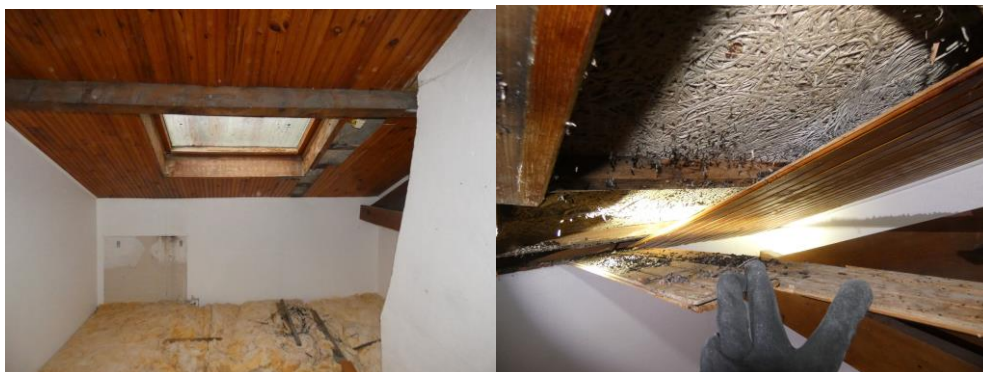
Les individus occupent l'espace entre l'isolant et le lambris dans les rampants du comble, sondage effectué en décembre 2022 en l'absence de la maternité.
