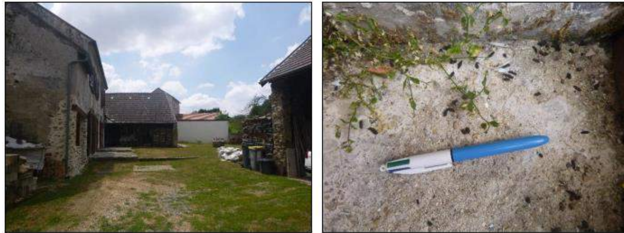
Figure 93 : Présence de guano frais de grosse taille au sol témoignant de la présence de quelques individus (Sérotine probablement) derrière le volet d'une habitation (Envol Environnement, 2019)
