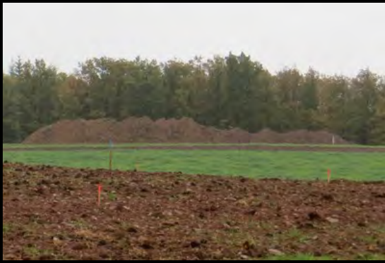
Figure 62 : Terre végétale stockée sur un chantier de centre photovoltaïque (Source : Abies, suivi de chantier)
