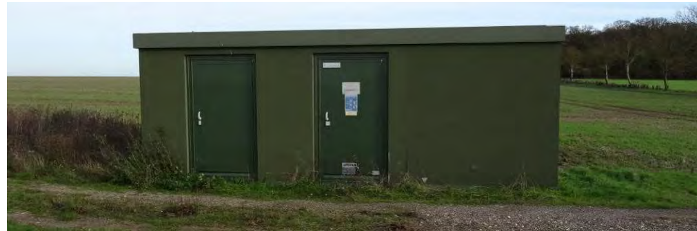
Illustration 80 : Exemple de poste de livraison avec peinture vert foncé
