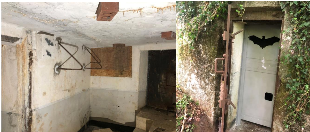
Photographie 7: Exemple d'aménagement intérieur d'un blockhaus et fermeture par une porte permettant le passage des chiroptères. (source © Vincent Cohez / CMNF)
