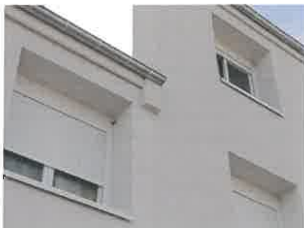
Bâtiment A, deux amorces aux fenêtres © S.Declercq
