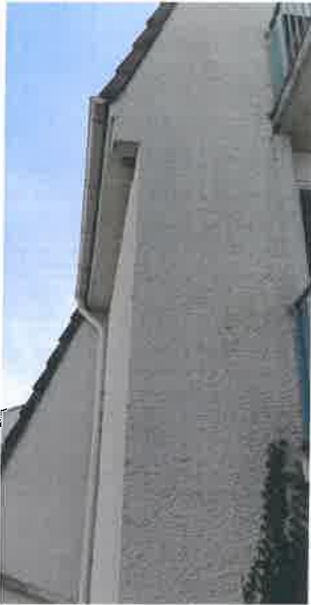
État initial : nid naturel derrière la construction latérale
