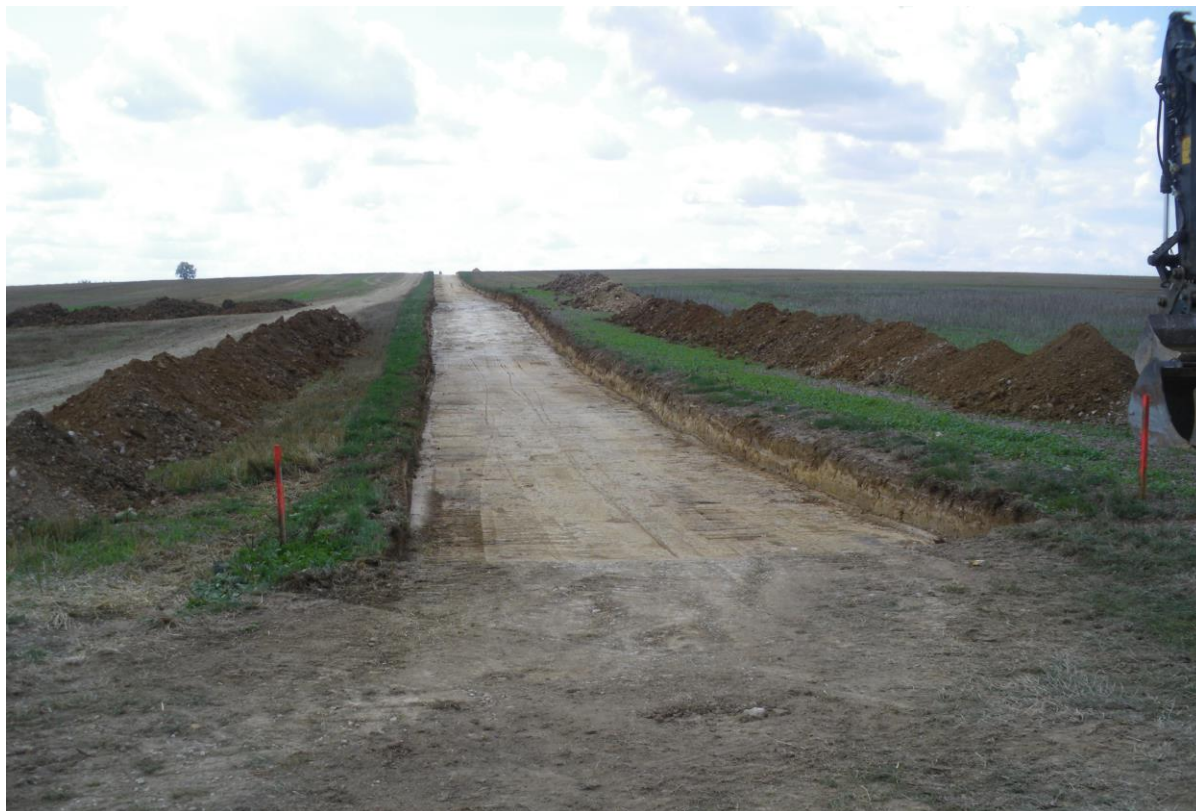
Excavation d'une fondation (préparation de l'assise et du passage des fourreaux en grave)
