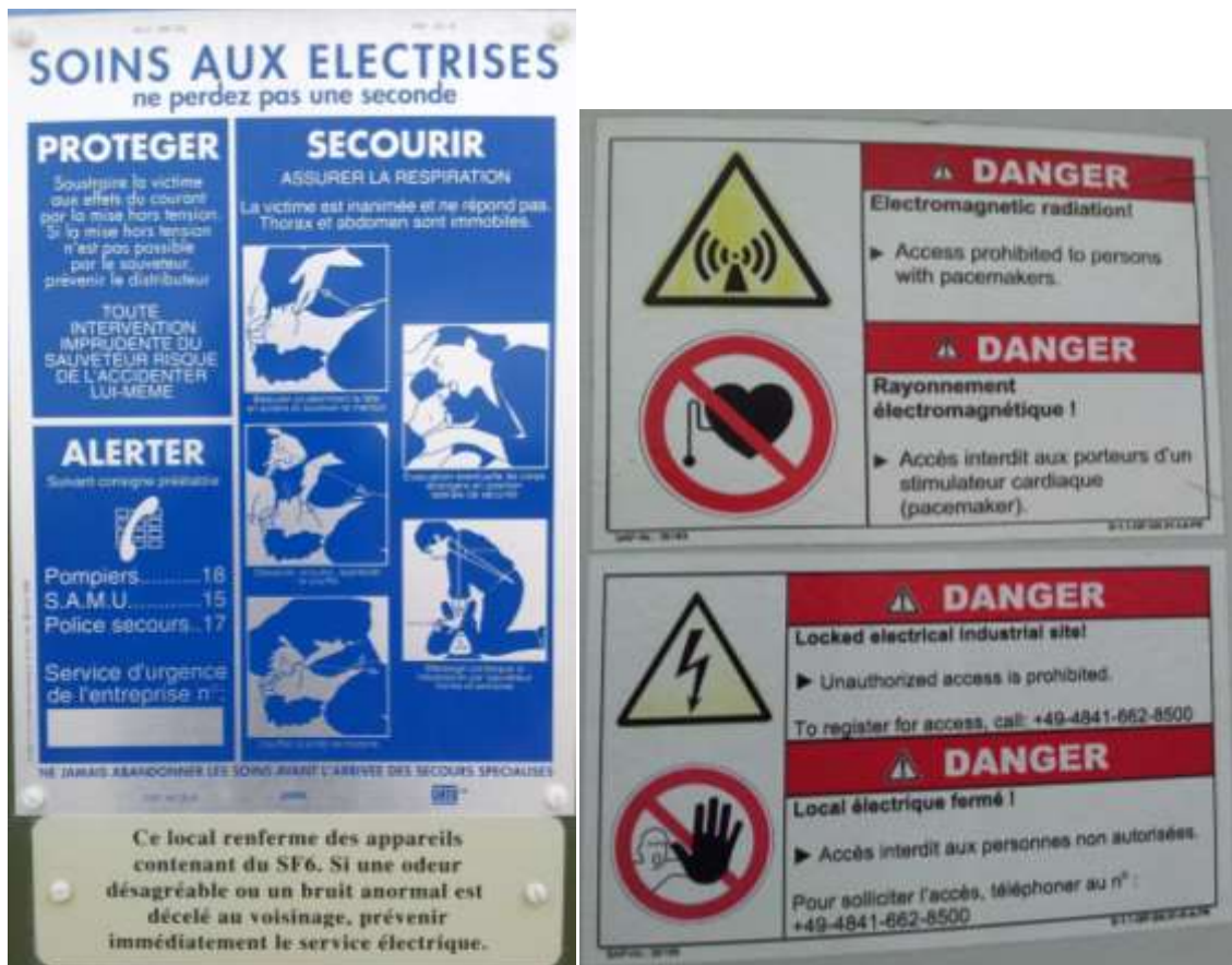
Figure 15 - Panneaux d'avertissement sur les portes des aérogénérateurs et du poste de livraison
