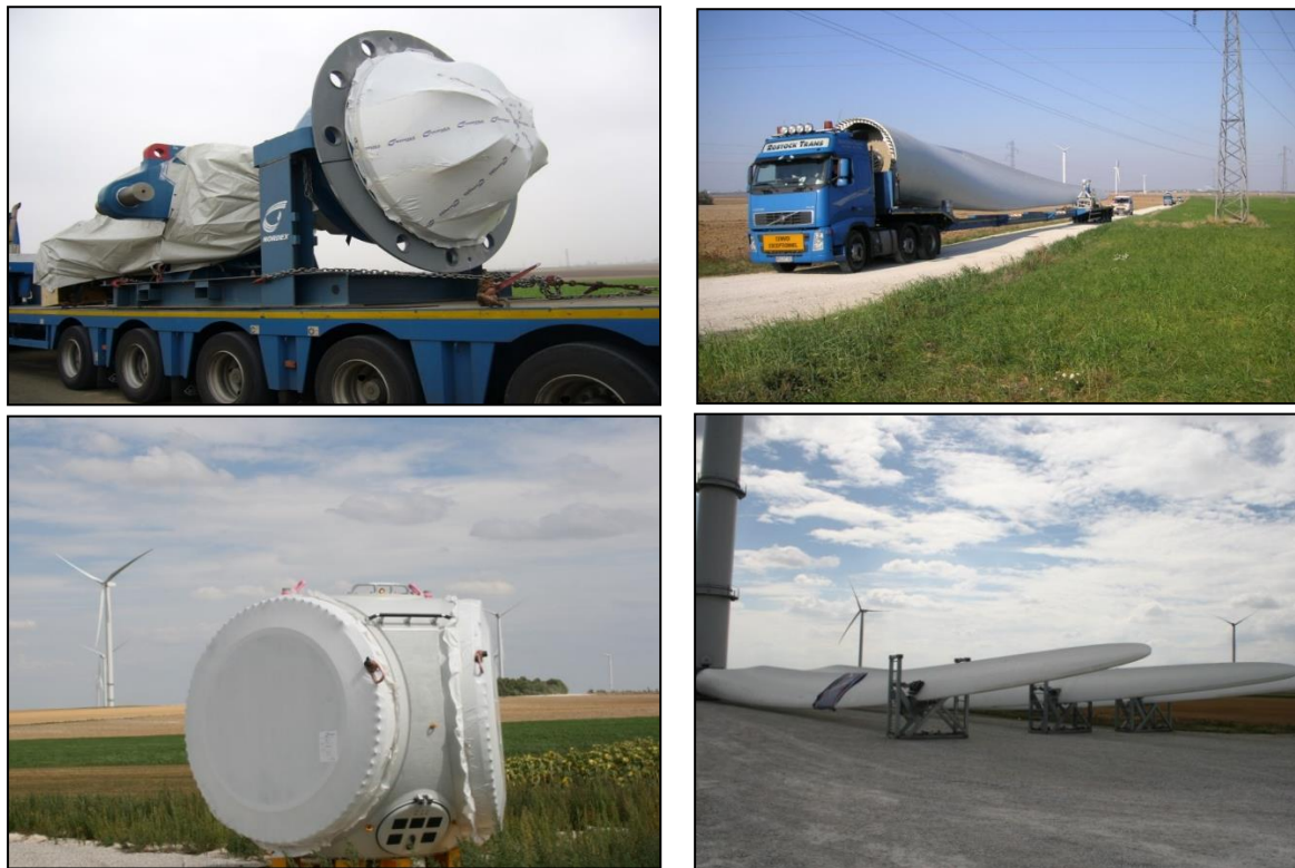
Figure 14 : Photos illustrant l'acheminement et le stockage des éléments des éoliennes – Source : NORDEX
