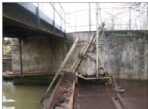
Vue 7 : Dégrilleur à remplacer
