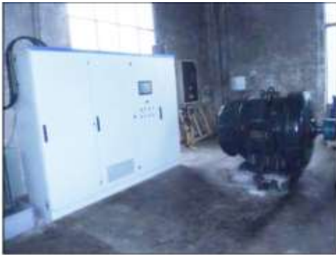
Vue 9 : Armoires d'automatismes
