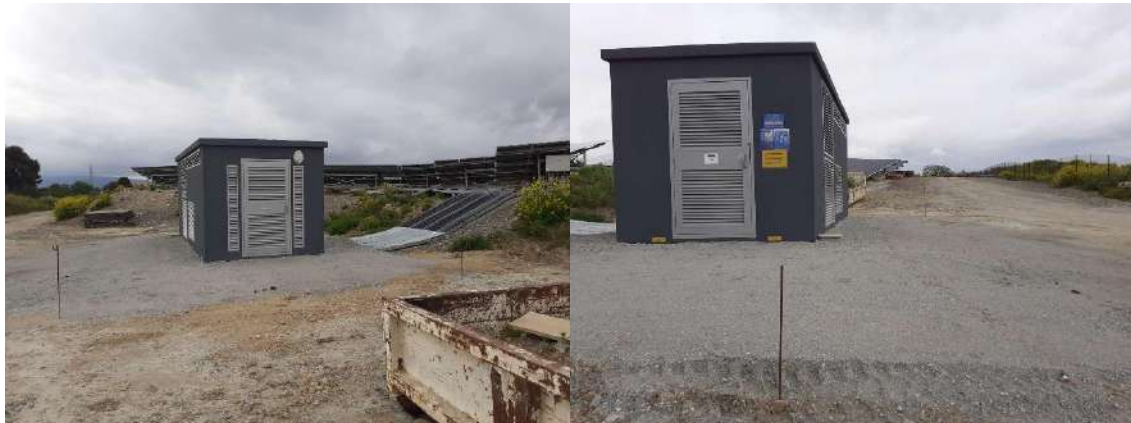
Figure 24 : Exemple de poste de transformation
