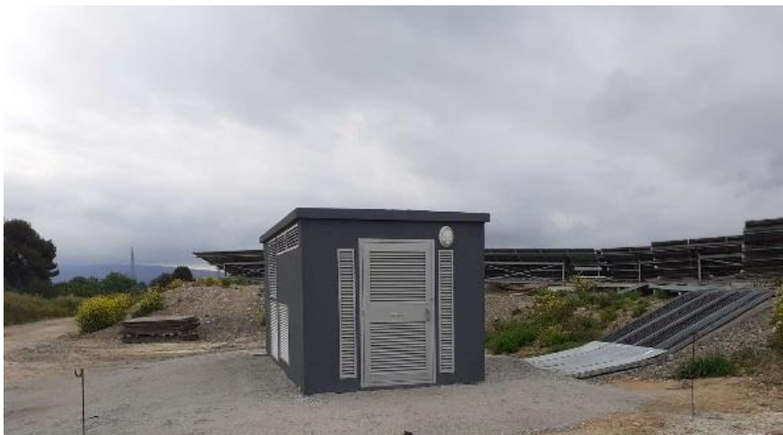
Figure 16. Exemple d'un poste électrique de transformation reposant sur une grave perméable À la sortie de la centrale photovoltaïque, au niveau du poste de livraison, une liaison avec le réseau public d'électricité sera réalisée par le gestionnaire du réseau.
