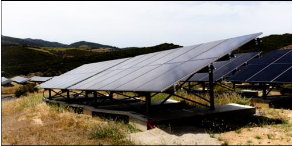
Figure 15. Exemple de panneaux solaires photovoltaïques fixés à la structure métallique de support, elle-même attachée aux longrines et dont les câbles sont placés dans des gaines
