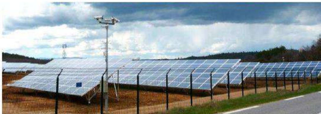
Figure 30 : Exemple de clôture et système de surveillance par caméras
