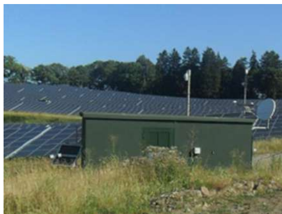
Figure 25 : Exemple de poste de livraison
