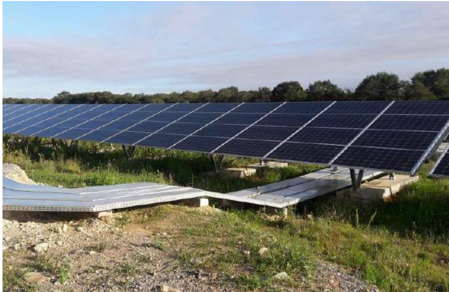
Figure 31: Exemple de chemin de câbles
