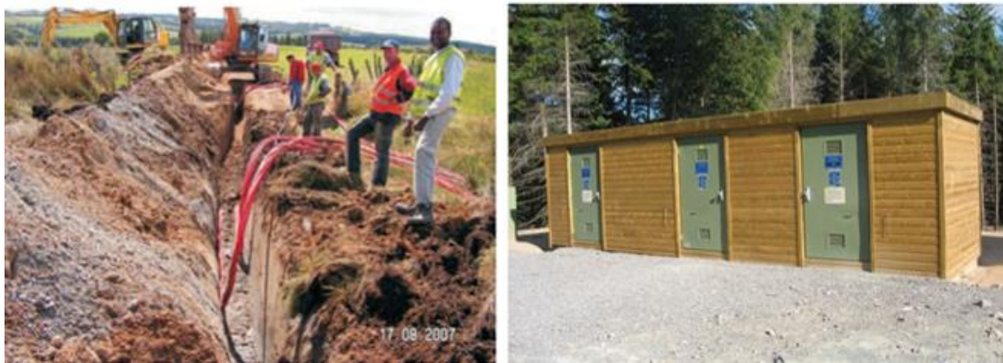
Figure 16 : Exemple de déroulage et pose des câbles (à gauche), poste de livraison (à droite)
